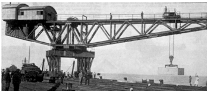
De bovenste foto toont een 50-ton Titan Block-Setting kraan aan het werk in East London, Zuid-Afrika.
